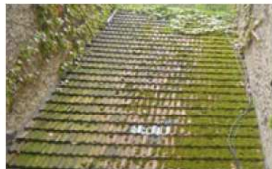
Vor der Oberflächenreinigung
