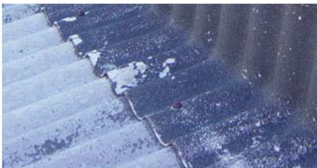
Beschädigte Oberfläche bei Faserzement-Wellplatten
