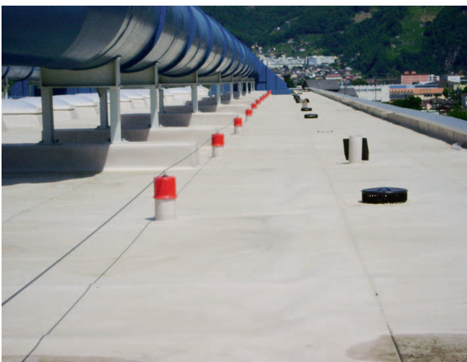
Seilsicherungssystem (Life-Line-System) auf einem Flachdach
