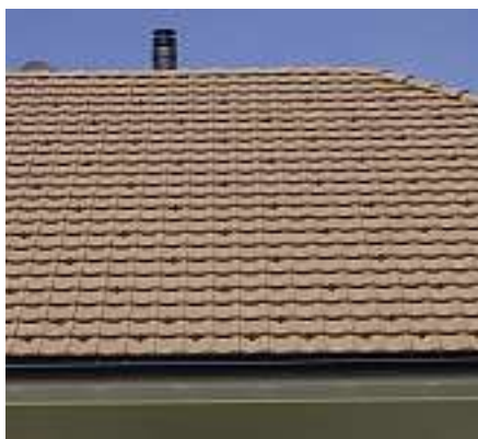
Fachgerecht geplant und eingebaut lassen sich Schneefangsysteme sehr gut in ein Dach integrieren ohne die Ästhetik zu beeinträchtigen.
