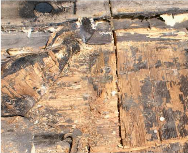
Abb. 3: Schadensbild Sekundärkondensat durch Restfeuchtverlagerung
