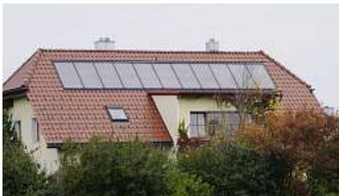
Photovoltaik- und Solarthermie-Anlagen sparen Energie und Kosten.
