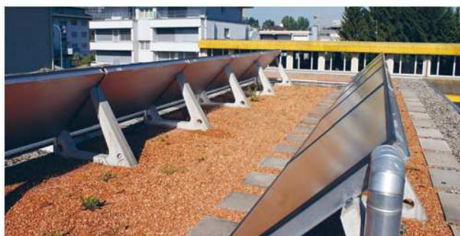
Sonnenkollektoren auf Betonaufständierung montiert. Gehwegplatten schützen das Abdichtungssystem bei Wartungs- und Unterhaltsarbeiten an den Modulen.
